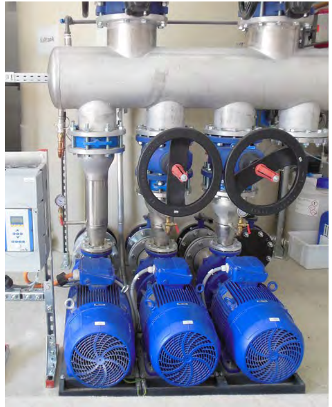
Eine der drei Pumpen ist drehzahlgeregelt. Sie dient als Spitzenlastpumpe und sorgt für eine bedarfsgerechte Einspeisung von rückgekühltem Wasser in den Kreislauf.
