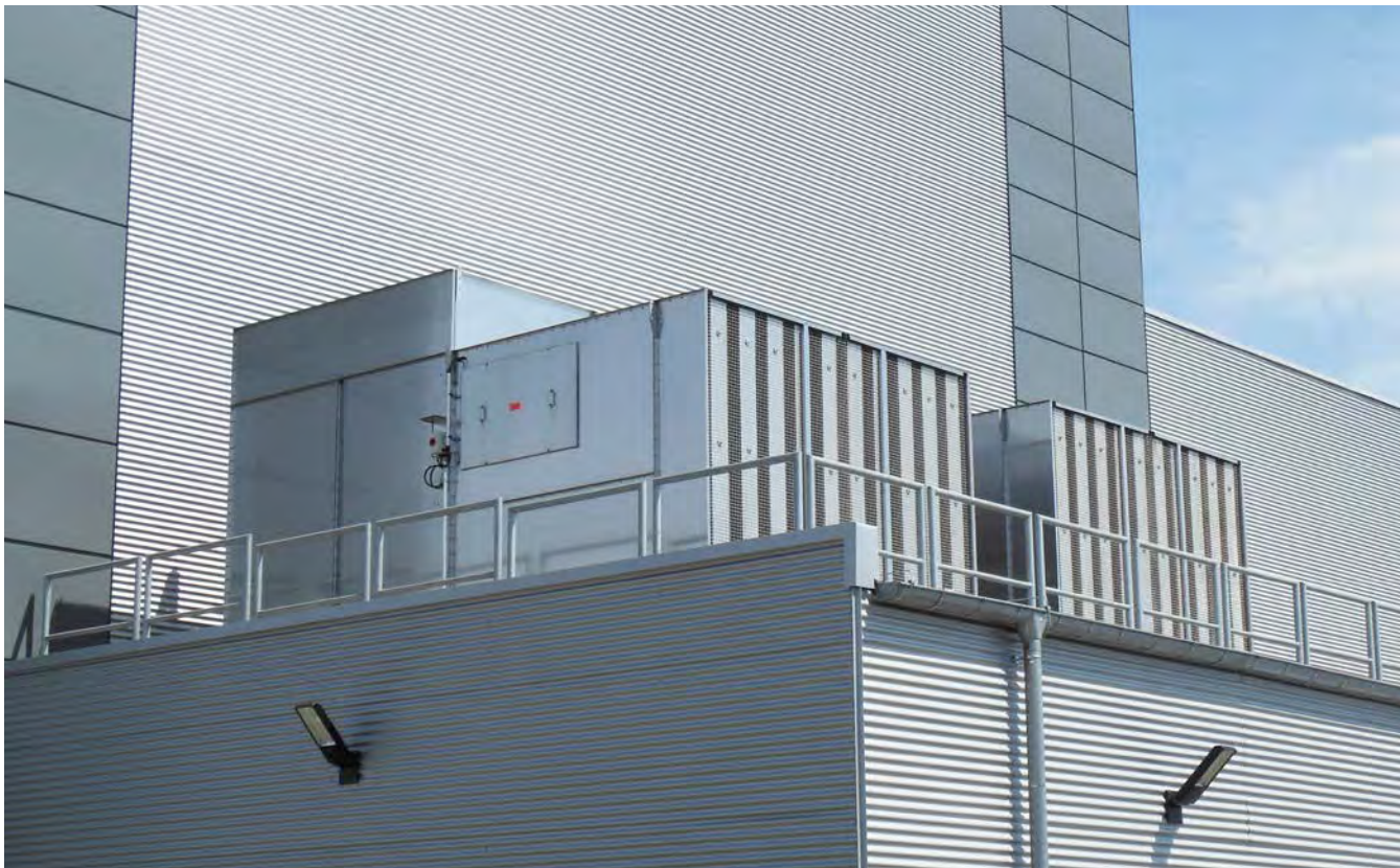
Die Kühltürme sind platzsparend auf dem Dach einer Produktionshalle installiert.
