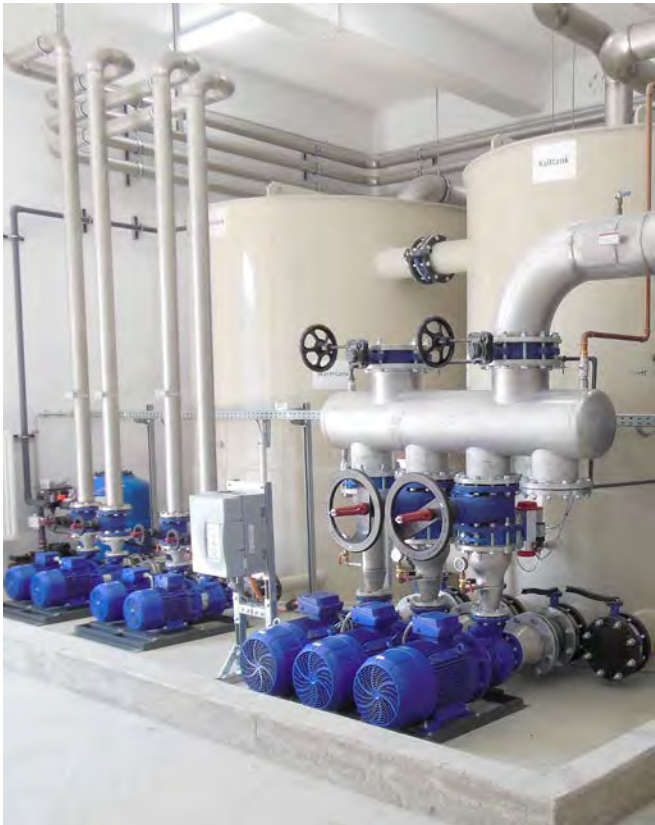
Die (vor den Kaltwassertanks angeordneten) Pumpen sind so ausgelegt, dass ein Höchstmaß an Energieeffizienz erzielt wird.
