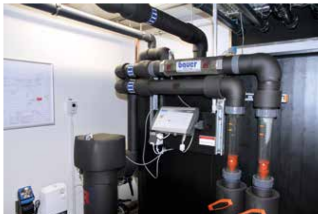
... und der Wasseraufbereitung.
