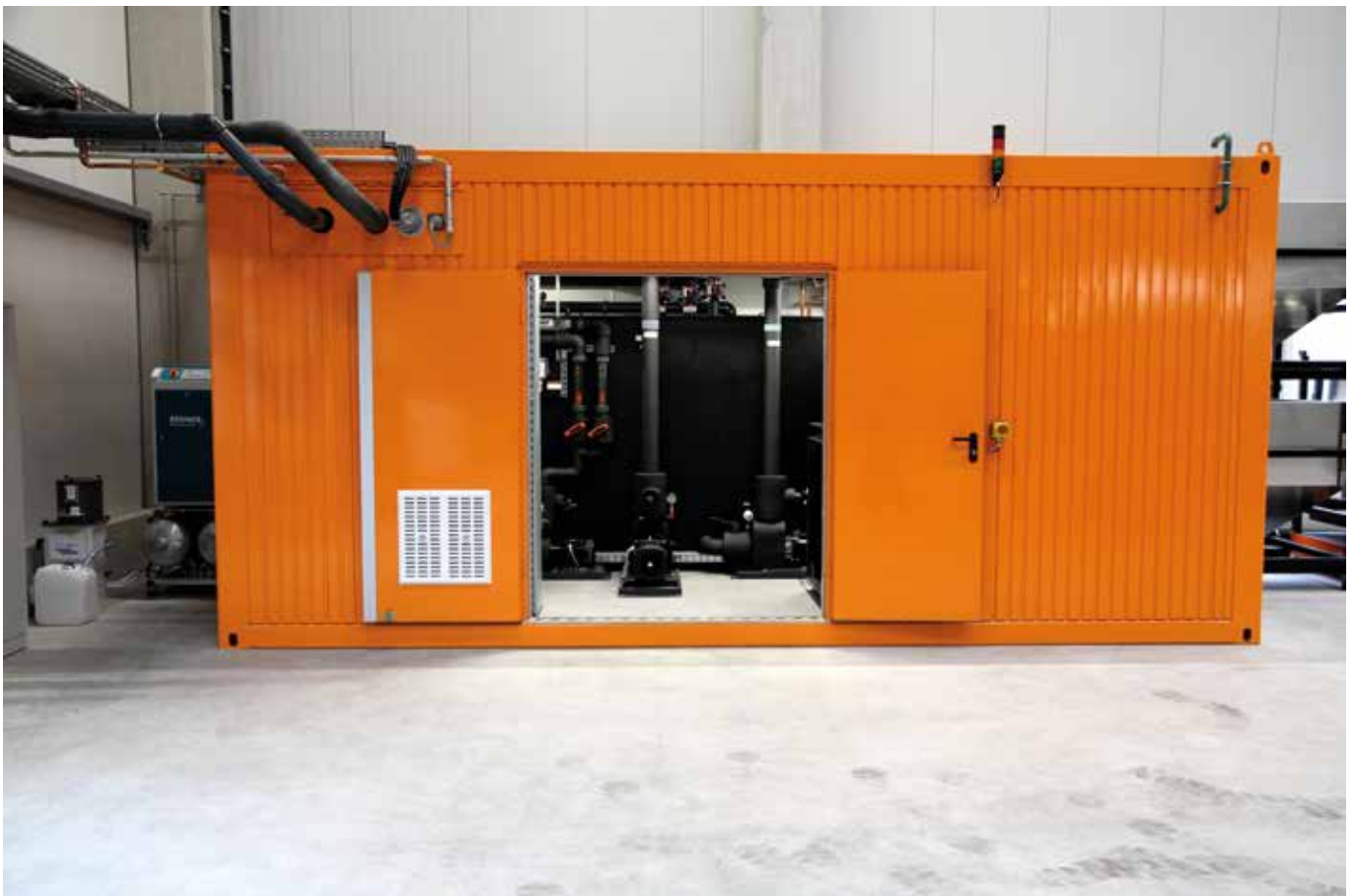
Die Kältetechnik zur Badkühlung wurde in einem Container untergebracht und anschlussfertig angeliefert.
