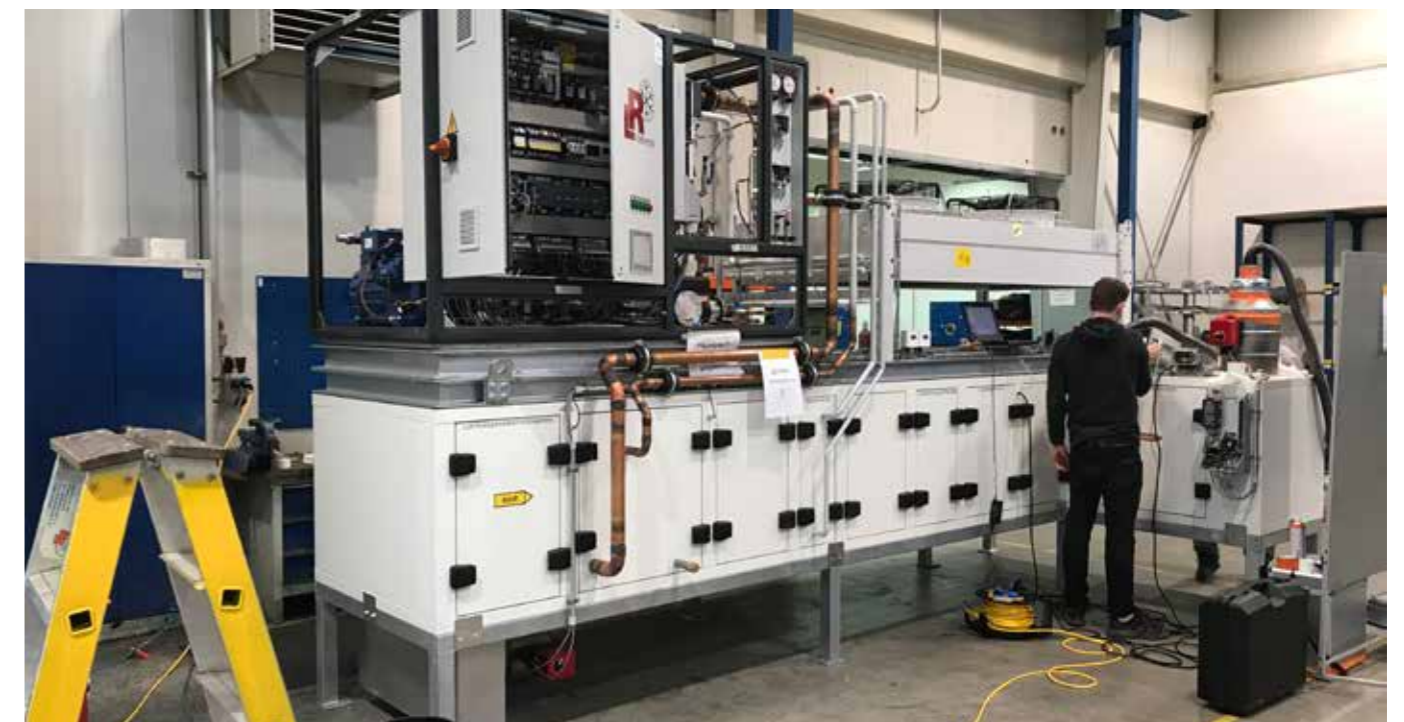
Anlage im Probetrieb mit Blow-Test.
