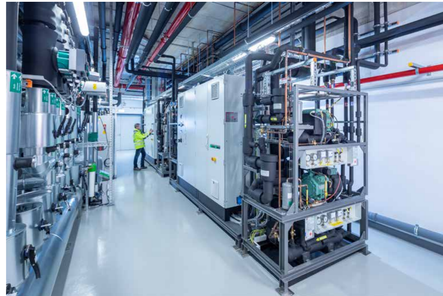
Die Kälteanlage erzeugt Kälte auf vier Temperaturniveaus von -10 °C bis -50 °C – mit hoher Effizienz und ausfallsicher, d.h. bei kompletter Redundanz.
