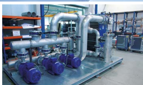
SHANGHAI - Wärmetauscher mit Pumpen-Tankanlage für den Werkzeug- und Hydraulikkreis
