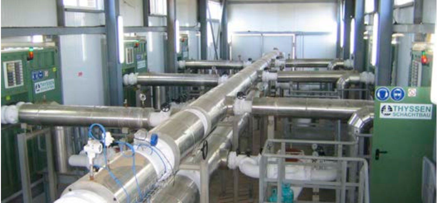
Von der Pumpenhalle zweigen mächtige Rohrleitungen zu den einzelnen Containern ab, in denen die Kälteanlagen untergebracht sind.
