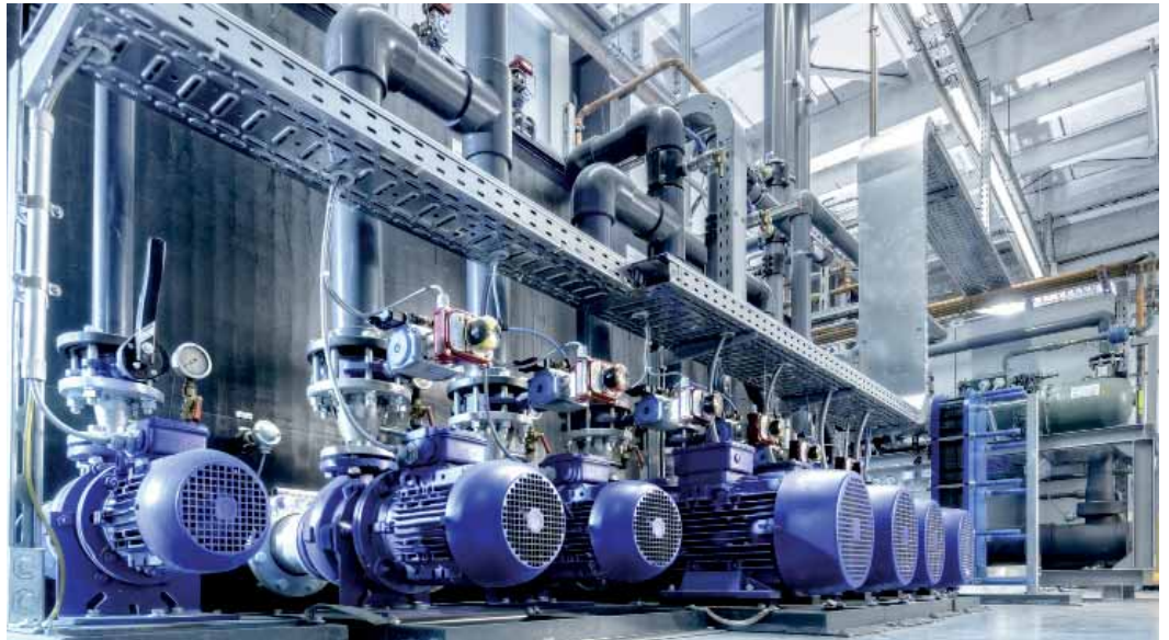
L&R Pumpen- tankanlage
