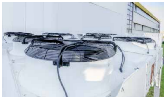
Luftgekühlte Kondensatoren mit energieeffizienten EC-Lüftern
