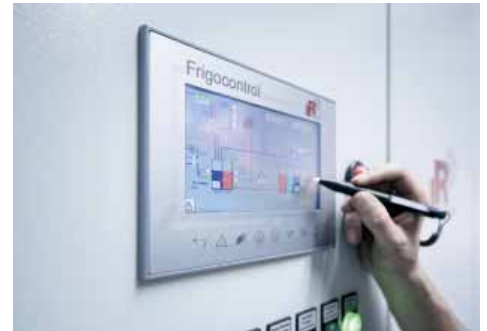
Frigocontrol-Steuerung mit Siemens SPS und Touchpanel
