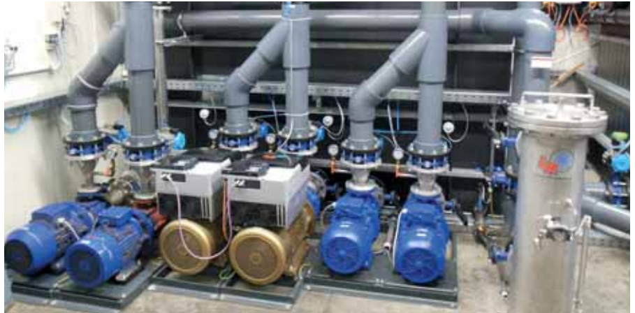
Pumpenanlage in Kombination mit Bestandspumpen.
